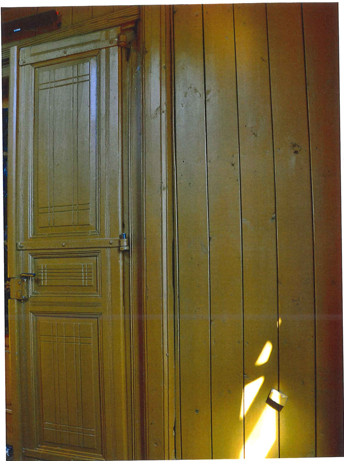
2. Ostrów, kościół parafialny pw. Najśw. Maryi Panny Królowej Polski, kruchta, 1923. Wnętrze przedsionka z zamkniętym skrzydłem drzwi wewnętrznych. Stan zachowania przed wykonaniem prac renowacyjnych. Widoczne olejne, ugrówne przemalowanie powierzchni drewna. 21.05.2024
