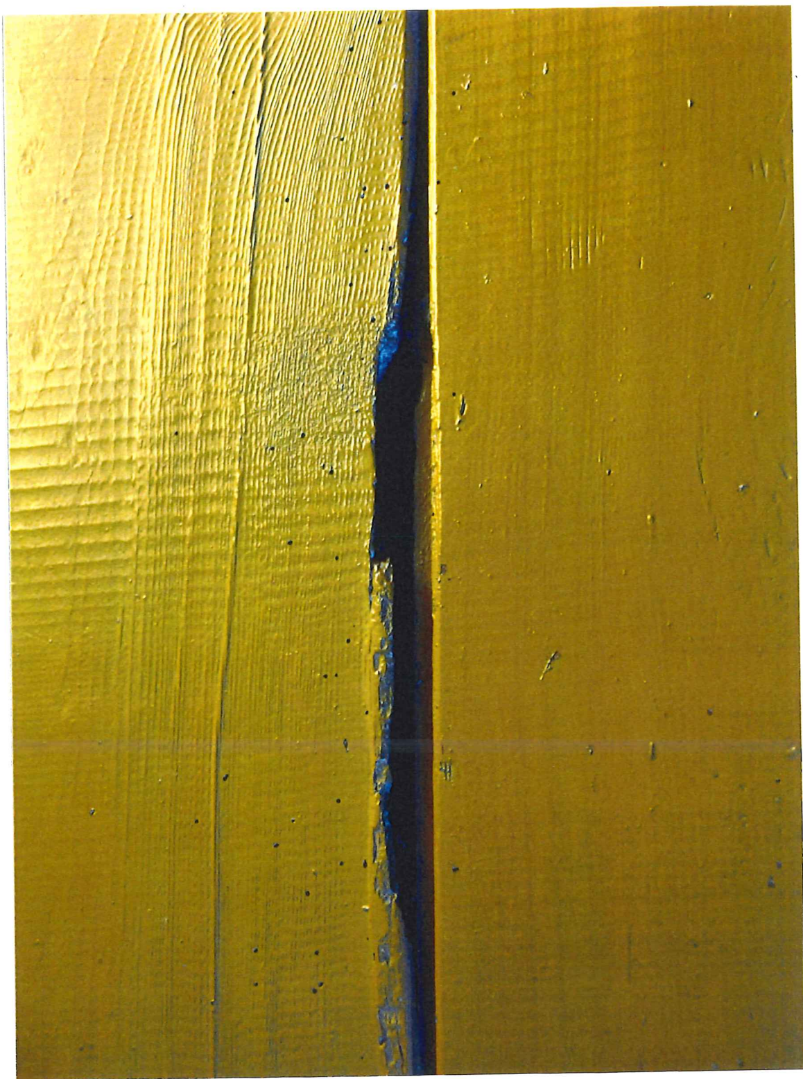
5. Ostrów, kościół parafialny pw. Najśw. Maryi Panny Królowej Polski, kruchta, 1923. Wnętrze przedsionka – zbliżenie pionowych desek. Stan zachowania przed wykonaniem prac renowacyjnych. Widoczne olejne, ugrówce przemalowanie oraz otwory po drewnojadach i ubytek drewna. 21.05.2024
