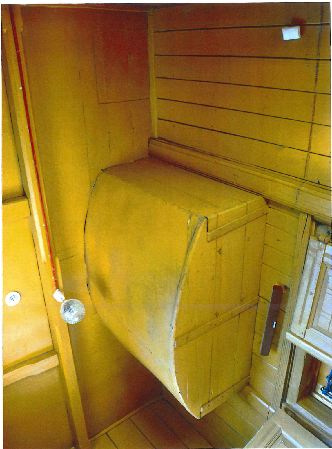
3. Ostrów, kościół parafialny pw. Najśw. Maryi Panny Królowej Polski, kruchta, 1923. Wnętrze przedsionka z nadwieszoną skrzynią organową. Stan zachowania przed wykonaniem prac renowacyjnych. Widoczne olejne, ugrówce przemalowanie powierzchni drewna. 21.05.2024 wyk. S. Kłosowski
