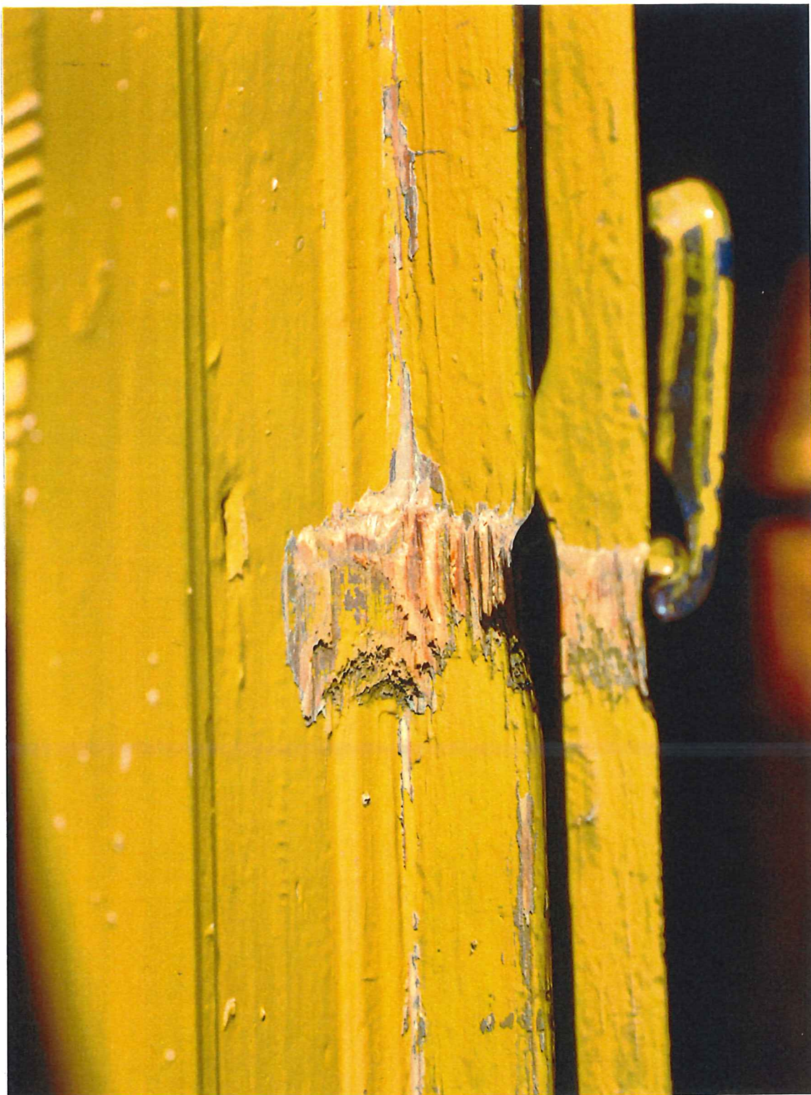
6. Ostrów, kościół parafialny pw. Najśw. Maryi Panny Królowej Polski, kruchta, 1923. Wnętrze przedsionka – zbliżenie. Stan zachowania przed wykonaniem prac renowacyjnych. Widoczne olejne, ugrówne przemalowanie oraz duży ubytek drewna. 21.05.2024
